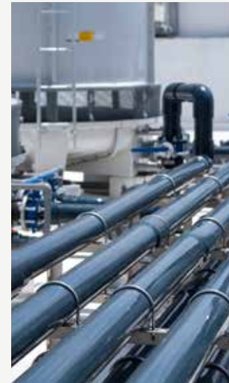
冷凍空調工程 Air Conditioning project
